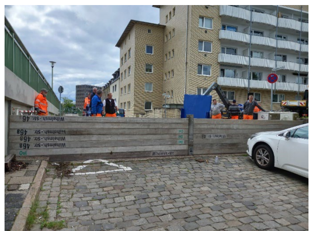
Dammbalkenverschluss in der Wilhelmshavener Straße
