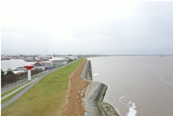
Treibselablagerungen auf dem Seedeich
