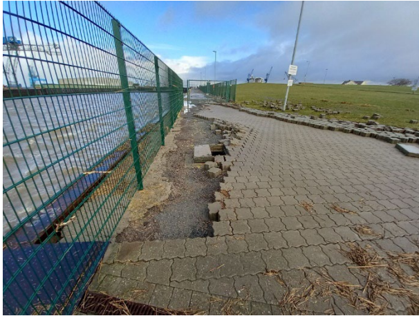
Pflasterschäden im Einfahrtsbereich der Kaiserschleuse
