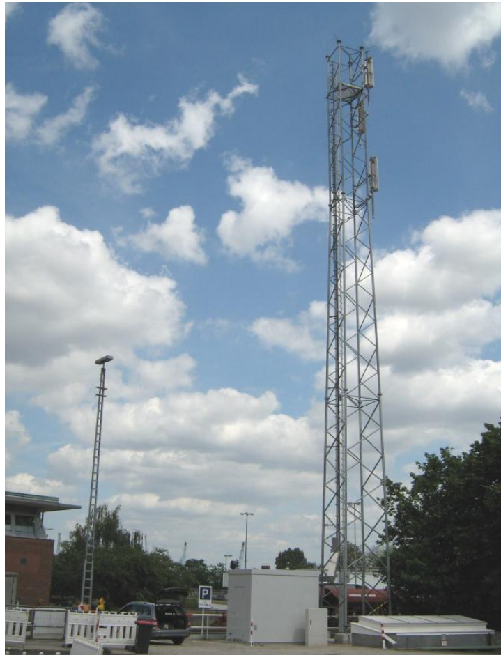
Abb. 17 Neuer Funkmast für 70 cm - Rangierfunk bei der Hamburger Hafenbahn, bremenports
